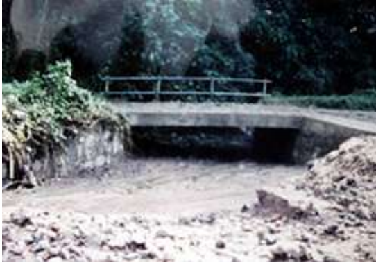
Puente derrumbado tras lluvias en mariona
