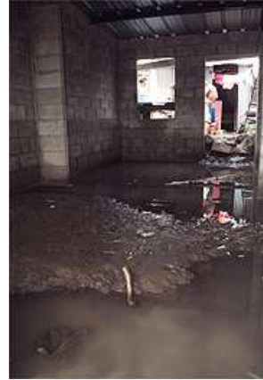
Vivienda inundada por lluvia
