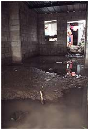
Vivienda inundada por lluvia
