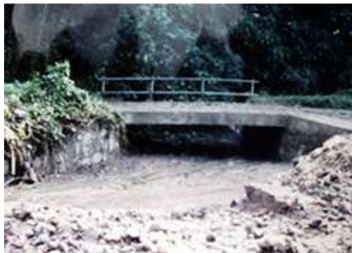
Puente derrumbado tras lluvias en mariona
