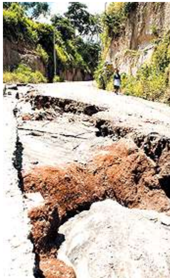
Carretera destruida por lluvias y deslizamientos
