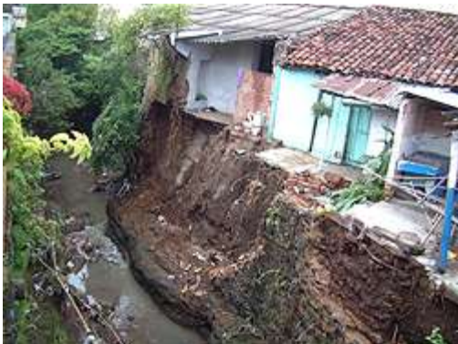
Los muros de viviendas situado a orillas de la quebrada Santa Lucía, en Santa Ana, cedió por las lluvias.
