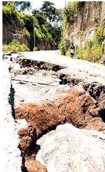
Carretera destruida por lluvias y deslizamientos
